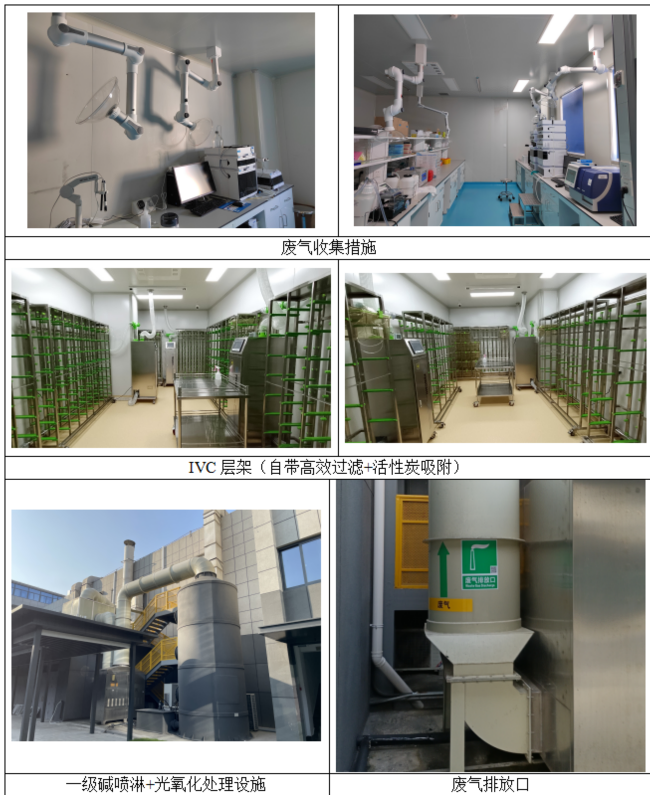
图 4-3 废气处理设施
